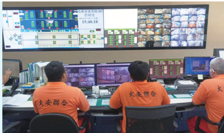
高雄港過港隧道監控畫面。
