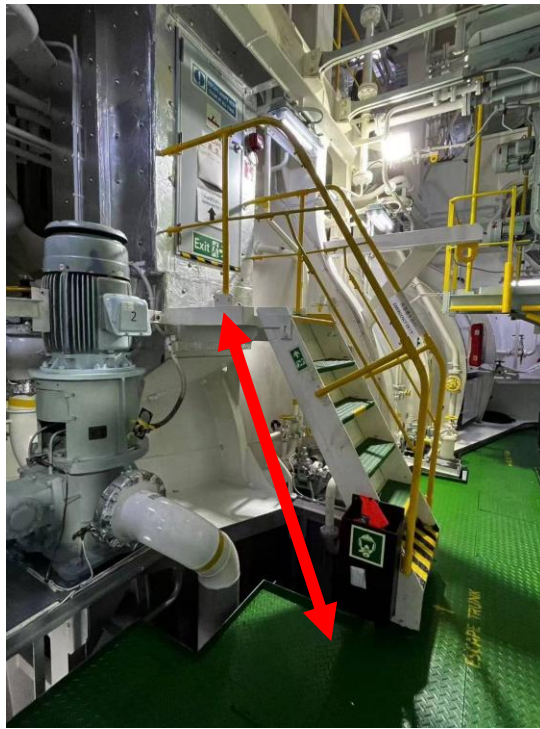
(圖7：逃生通道需藉由斜梯(紅箭頭處)連接機艙空間最底層甲板，可能被認定為不符合規定)
